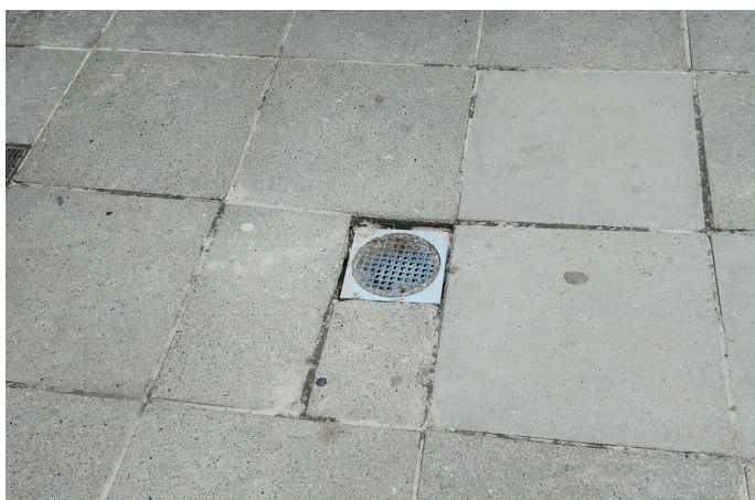
Abb. 14: Einlauf im Eingangsbereich. Die Dimensionierung ist nicht mehr zeitgemäß (p+t)
